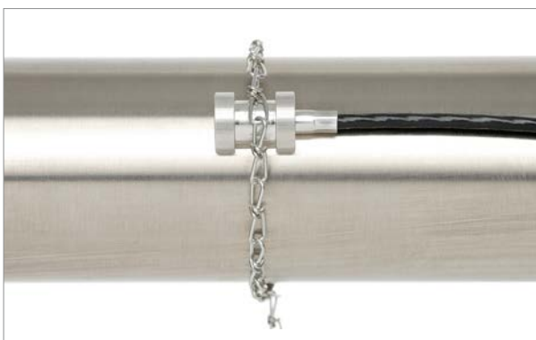
Am Rohr befestigter PT100-Temperatursensor
